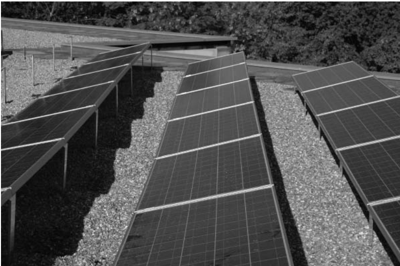
Illustration d'une installation rattachée – exemple de l'école des Crêts-de-Champel
